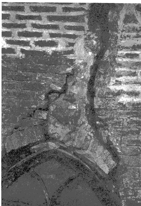
تصویر ۲ ارومیه - مسجد جامع، ترک ناشی از زمین لرزه در زیرگنبد.
