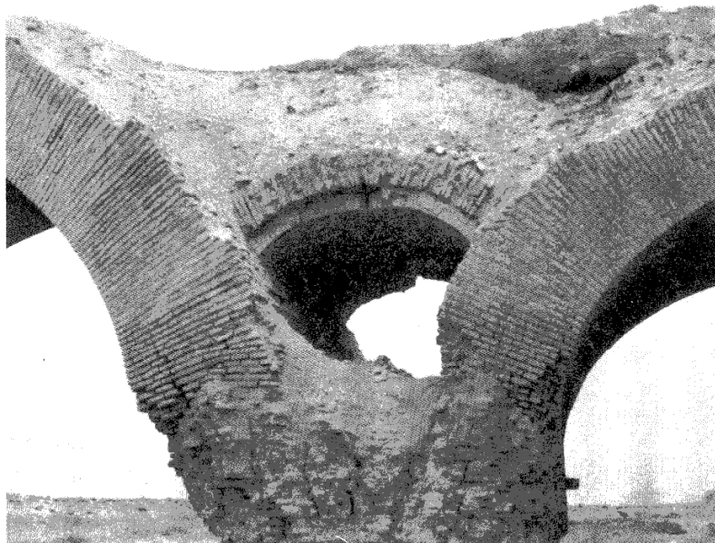
تصویر ۱۷ پل رودخانه شور - کرج؛ ضایعات در پایه.
