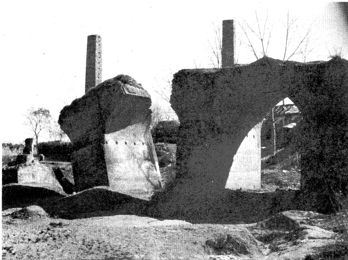
تصویر ۱ ساری، فرح‌آباد - پل رودخانه تهن، آسیب بر اثر سیل.
