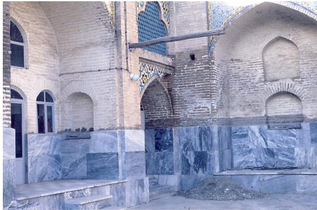
تصویر ۲ کرمانشاه - مسجد عمادالدوله، جلوگیری از تنفس بنا بر اثر نصب سنگ مرمر و ملات سیمان در آزاره و همچنین در کف و در نتیجه حبس و هدایت رطوبت به سطوح بالاتر می شود.
