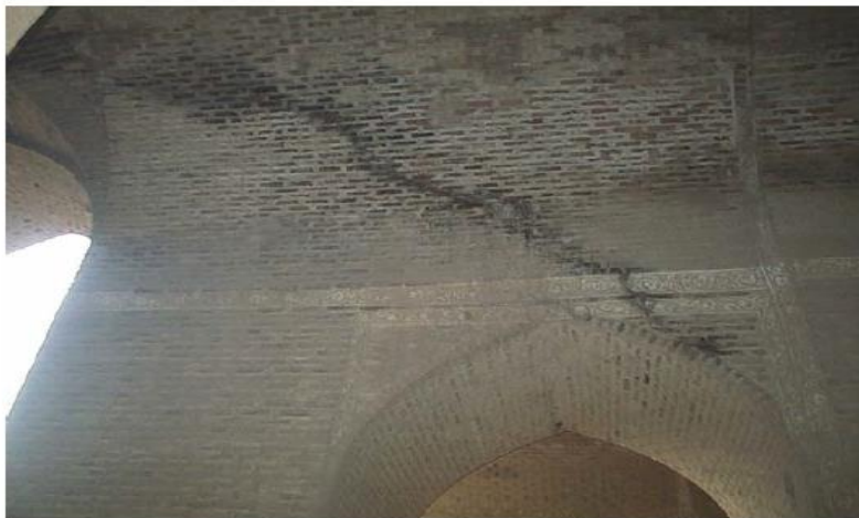
تصویر ۱ ورامین-مسجد جامع، ترک بر اثر نشست پی در شبستان مسجد.
