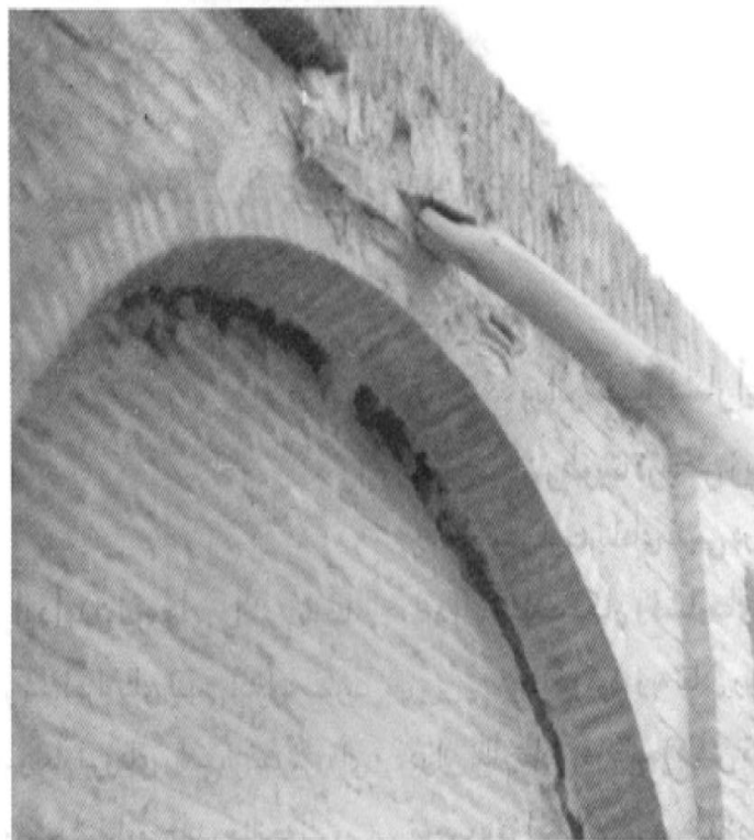
تصویر ۴ مقبره‌ی شاه نعمت الله ولی، پیش از یافتن علت اصلی آسیب، با استفاده از شمع بندی، عمل رفع خطر انجام می‌گیرد.
